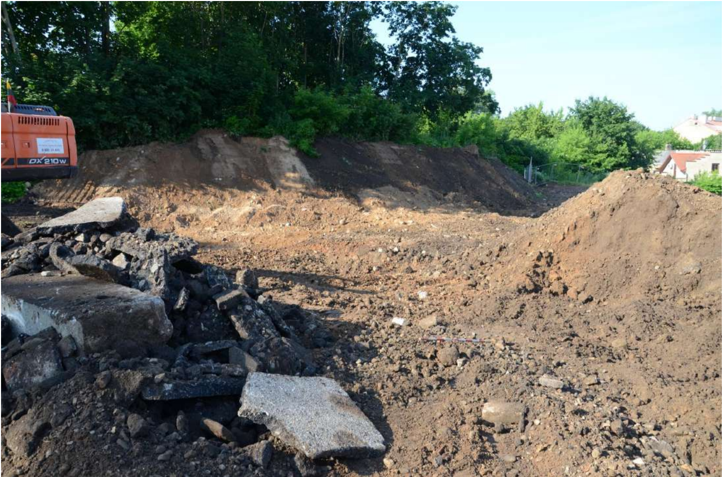
5. Žvalgymai P, PV sklypo dalyje, griauinant garažus ir atraminę sieną. Vaizdas iš Š.
